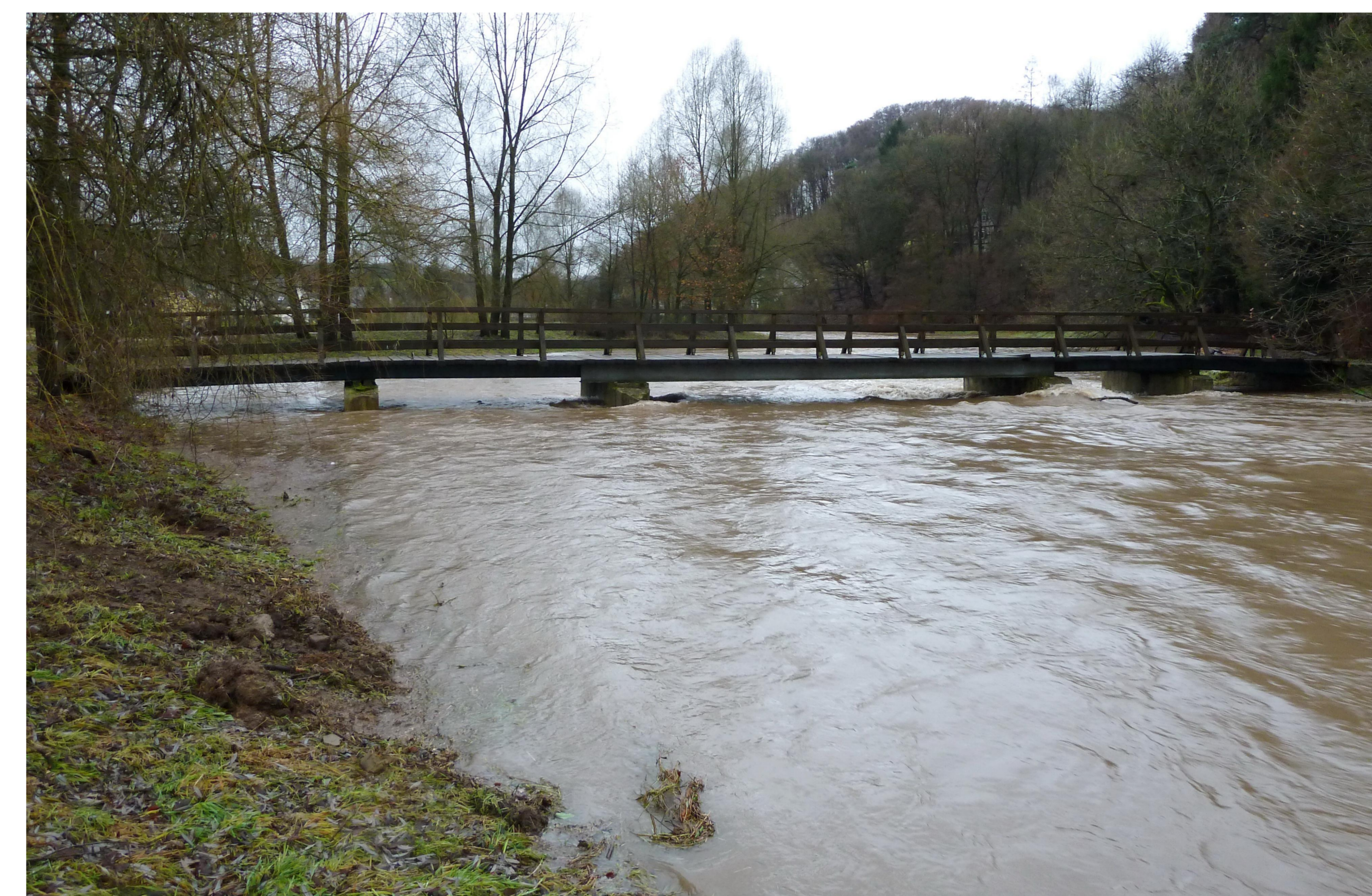
Hochwasser der Sülz am 14.11.2010 in Hoffnungsthal: Potenziell große Gefährdung durch Schwemmgut an der Brücke im Sülzbogen
